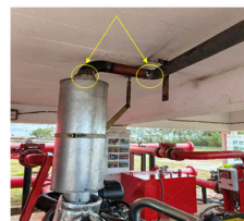
Raccordement échappement gaz du nouveau groupe motopompe DCI.
